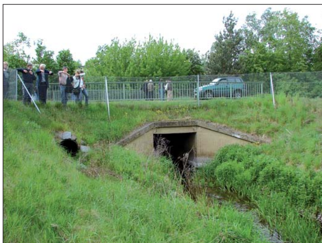
Obr. 1 Podchod pod cestnú komunikáciu vytvorený ako nápravné a kompenzačné opatrenie pre vydru riečnu v rámci EIA v Nemecku Fig. 1 Underpass for otter under the road realized as a compensation and revitalization scheme within EIA process in Germany
