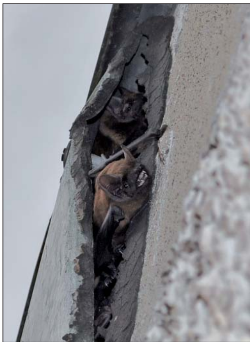
Kolónia netopierov v porušenej plechovej izolácii nad balkónom obytného priestoru, foto: L. Kočíková
