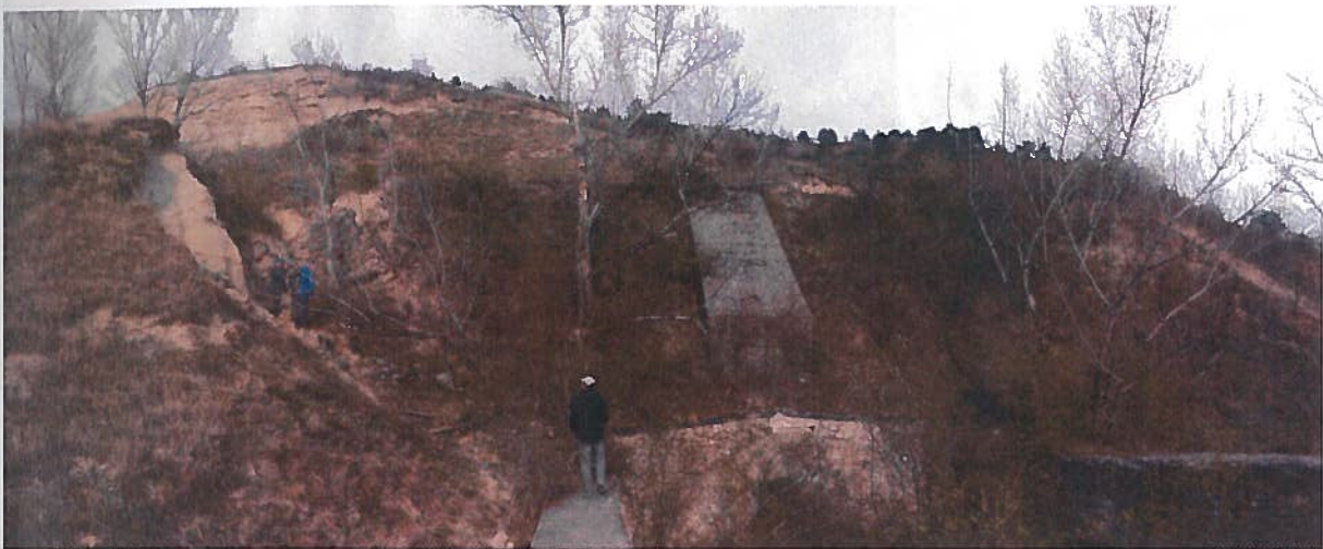
Obr. 5: Panoramatický pohľad na zrútenú časť oporného múru
