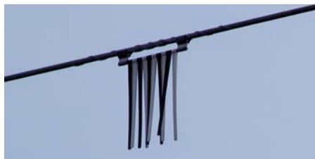
Špeciálne odkláňače letu vtákov na 110 kV vodičoch elektrického vedenia v oblasti CHVÚ Lehnice
