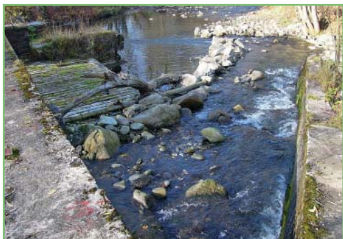
Ryby majú dve plynulé výstupové trasy – vpravo rýchlejšiu hlbokočinu pre pstruhy a lipne, vľavo pomalší plytký prúd pre čereble a hlaváče. Celý prietok tečie prioritne cez rybovod. Foto: autor
