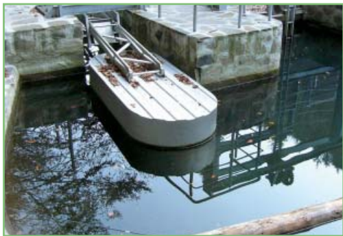
Stabilne veľký vtok vody do rybovodu automaticky reguluje veľký oválny plavák. Vpredu plávajúce hradenie proti vniknutiu plavenín. Foto: autor
