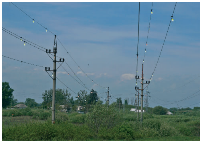
Ekologizované vedenie 22 kV s inštalovanými prvkami FireFly foto: M. Balla
