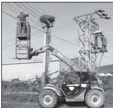
Vypnutie elektriny na „živom“ stĺpe musí skontrolovať elektrikár...
