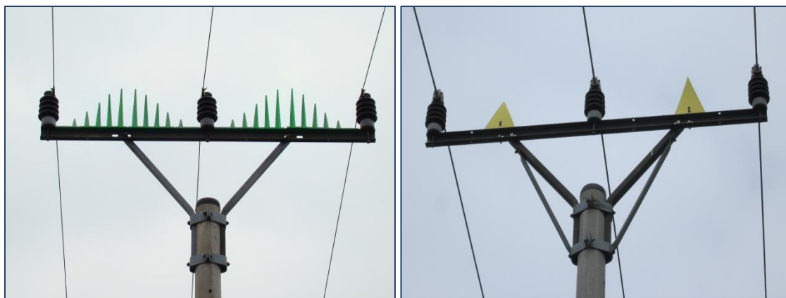
Obr. 42 Staré neefektívne riešenia, odporúčané na výmenu počas rekonštrukcie vedenia
