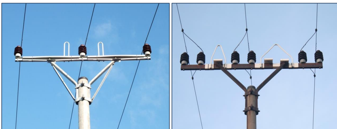
Obr. 34 Ekokhránička na jednozávese (vľavo) a ekozábrana na dvojzávese vedenia 22 kV (vpravo)
