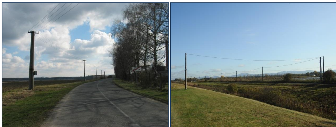
Obr. 7 Vedenie 230/400V slúži na prenos prúdu ku koncovým odberateľom
