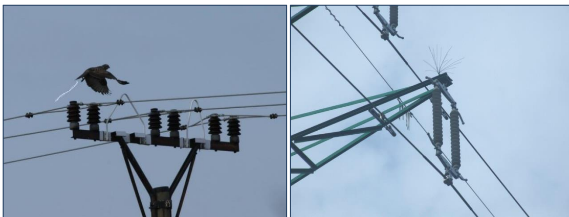
Obr. 27 Streamer (výlučok) a paprsková zábrana na konci ramena nad izolátorovým reťazcom
