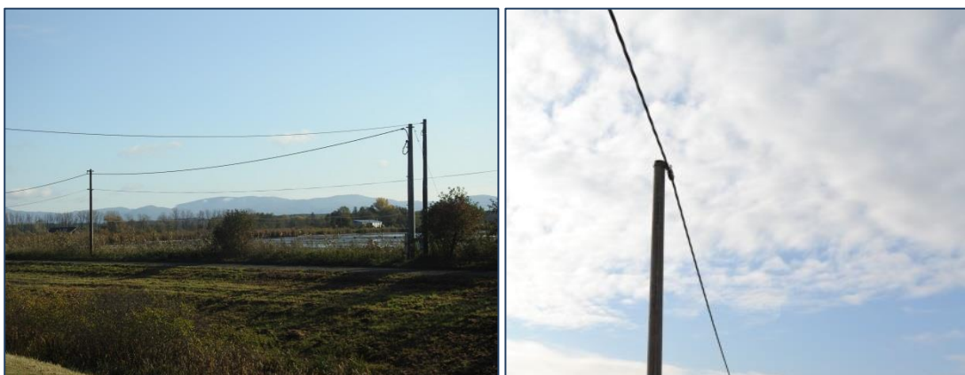
Obr. 56 Hrubý káblový zväzok predstavuje efektívne alternatívne riešenie pre zviditeľnenie rizikových úsekov VN a NN vedení
