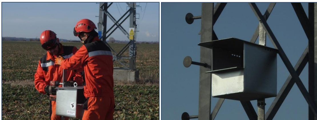
Obr. 33 Využitie hliníkových búdok na distribučných vedeniach (110 kV) pre sokola myšiara a myšiarku ušatú
