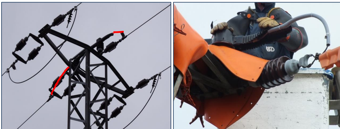
Obr. 36 Vyznačenie rizikových častí preponiek, ktoré zostali neošetrené a správna kombinácia plastových krytov izolátorov a izolačných silikónových návlekov
