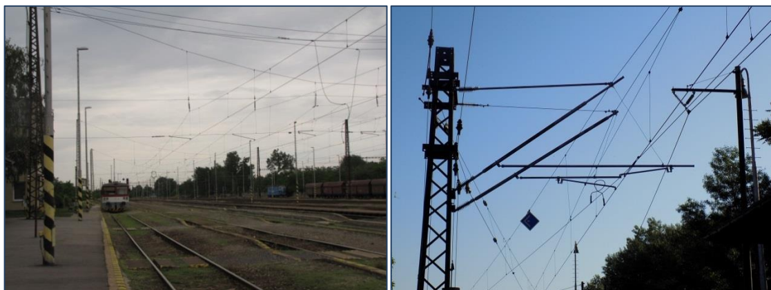
Obr. 6 Trakčné elektrické železničné vedenia o napätí 25 kV
