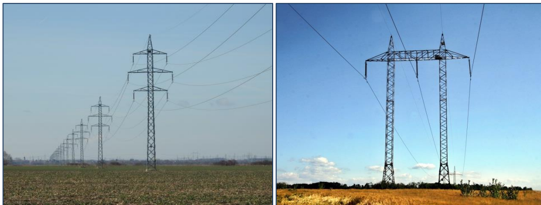
Obr. 4 Vedenie typu 110 kV (vľavo) a 220 kV (vpravo)
